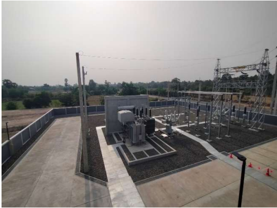
สถานีไฟฟ้ารัตนบุรี
